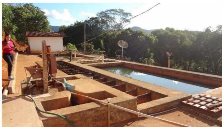
Figura 3-41 - Estação de Tratamento de Água Itarana.
