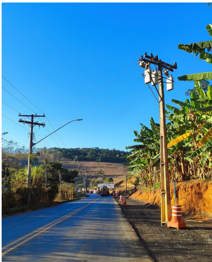
Figura 01 – Poste a ser removido às margens da Rodovia ES-261.
